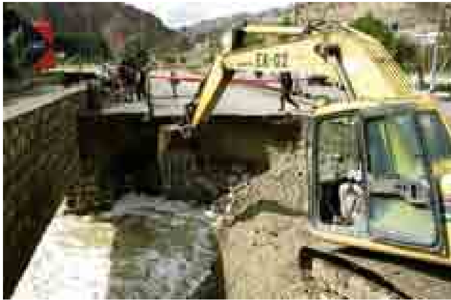
Sifonamiento en la avenida Costanera. Fuente: GMLP
